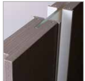
górna krawędź skrzydła bez przyłgi
